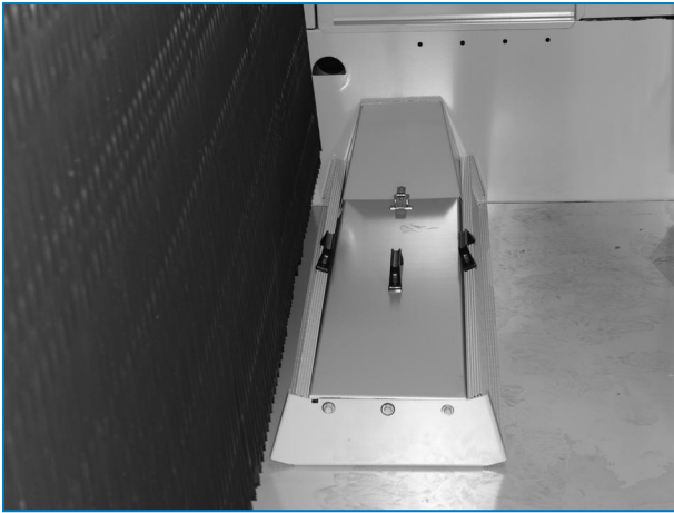
Kaltwasserbecken und Beckenlochblechsiebe
