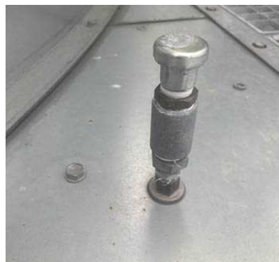
Luchtaanzuiging op ventilatorplatform
