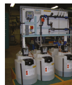
Echipament de tratare a apei
