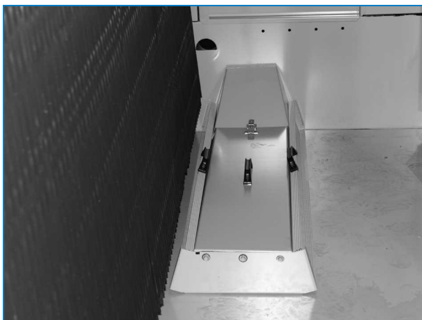
Nádrž na ochlazenou vodu a filtry nádrže
